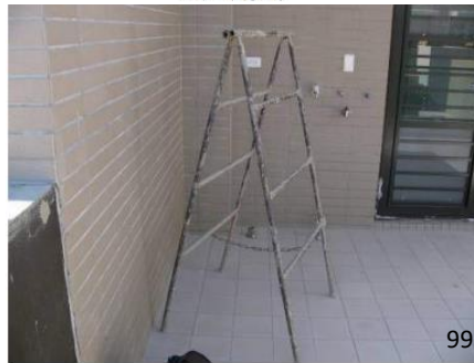
照片2 合梯缺固定繫材
