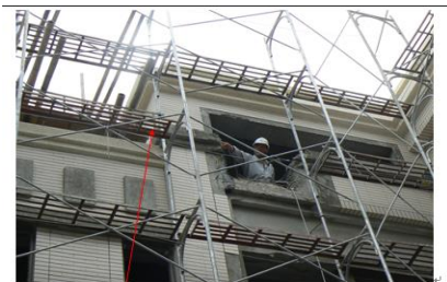
罹災者從所站××戶外牆施工架工作台第6層處往旁邊未鋪設施工架工作台之方向墜落，並墜落於距地高約9.9公尺之××戶地面上。
