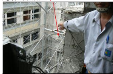
罹災者從所站××戶外牆施工架工作台第6層處往旁邊未鋪設施工架工作台之方向墜落，並墜落於距地高約9.9公尺之××戶地面上。
