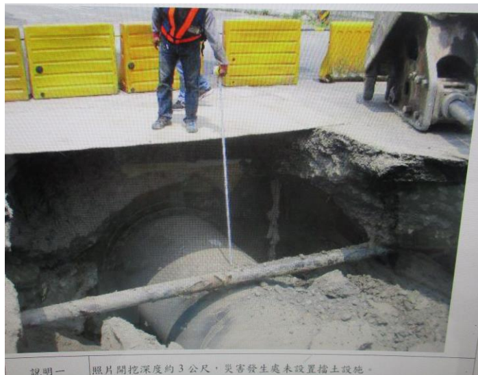
說明一 照片開挖深度約3公尺，災害發生處未設置擋土設施。
