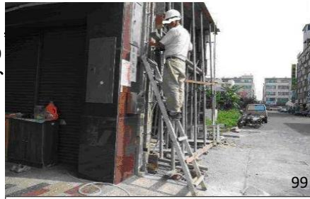
罹災者站立於距地面約110公分之移動梯，該移動梯係鋁製合梯併攏斜靠在車庫左側柱模上，從事距地面280公分之車庫左側模板鑽孔作業（照片所顯示為模擬工作當時之情形）
