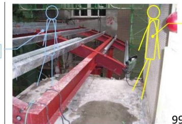
說明：勞工丙位於陽台左邊，勞工乙位於陽台右邊靠牆處，兩人各持一台手持破碎機一起打石。勞工乙停止作業放下破碎機，站起來背靠在右側牆壁上，約3秒鐘就往他的右側直立倒下並從陽台邊緣墜落。
