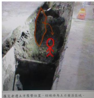
罹災者遭土方壓擊位置，紅圈標為土石崩落區域。
