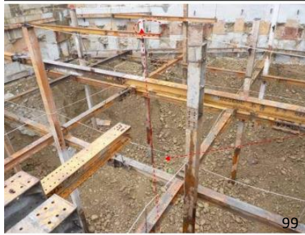
說明 罹災者王○○墜落前所在位置(距開挖底面高約 12 公尺之型鋼上)
