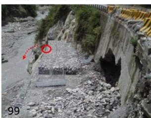
石籠邊緣未設置護欄、安全母索(紅色圈圈為罹災者的站立墜落位置)
