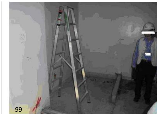
照片一、罹災地點位於 62 病房醫師值班室，勞工罹災時使用合梯不慎墜落
