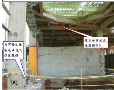
附照 2、災害發生處，罹災者墜落高度 9 公尺。
