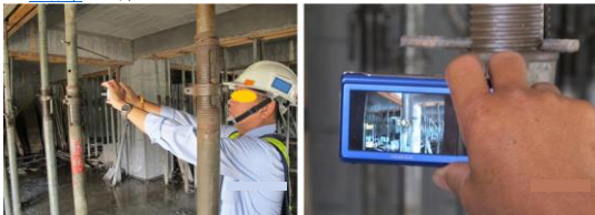
可調鋼管支柱檢查情形(違規使用情形如右圖所示)
