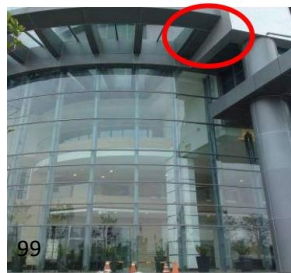
罹災現場情形。(罹災者死亡位置，採光罩高度量測14公尺)
