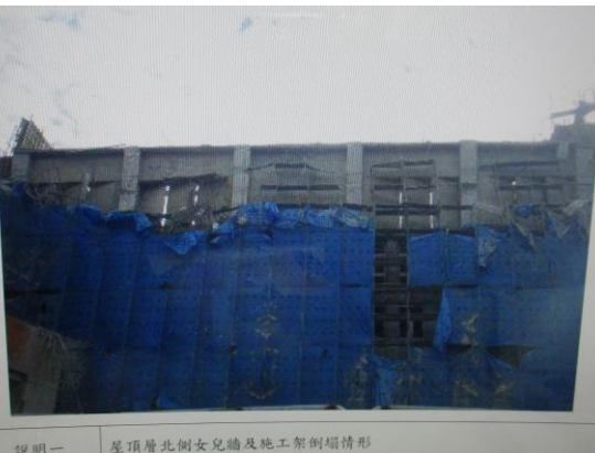
說明一 屋頂層北側女兒牆及施工架倒塌情形
