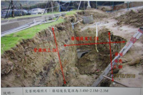
說明一 災害現場照片：崩塌後長寬為3.4M×2.1M×2.3M
