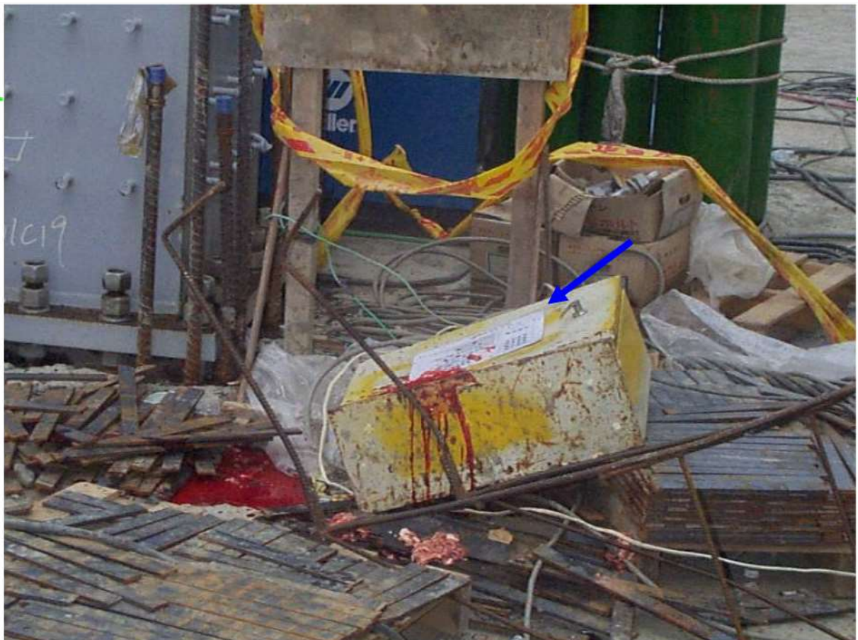
罹災者墜落頭部撞擊配電箱
