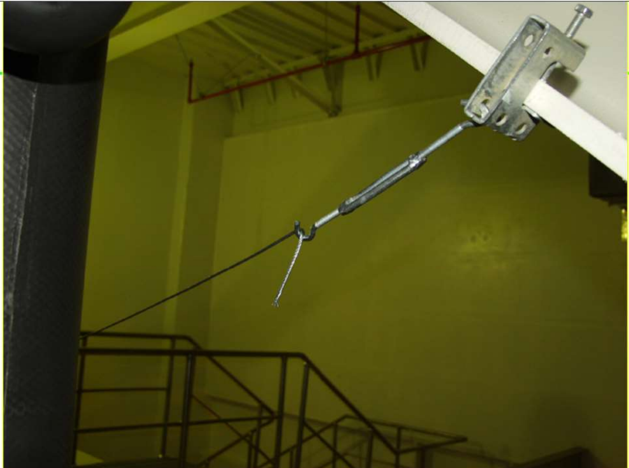
馬鞍環脫落後鋼線復原照片
