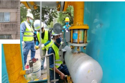
新竹瓦斯公司中正國小整壓站軸流閥故障引起竹北氣爆，新竹縣政府事後檢視全縣瓦斯管線設備，並預防性更換全縣軸流閥流體。新竹縣政府提供
