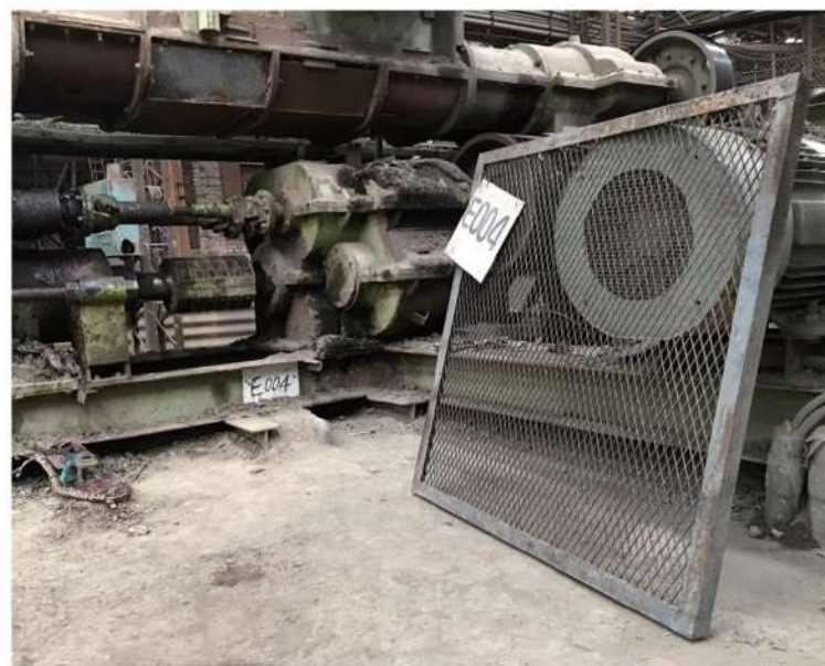
▲ 未於傳動軸有危害勞工之虞處設置護罩、護圍、套洞、跨橋等安全設備，亦未停止該機械運轉。
