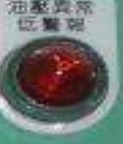
R10 潤滑油泵 油壓異常低警報
