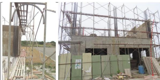
施工架工作臺(高度6.8公尺)墜落至地面。
