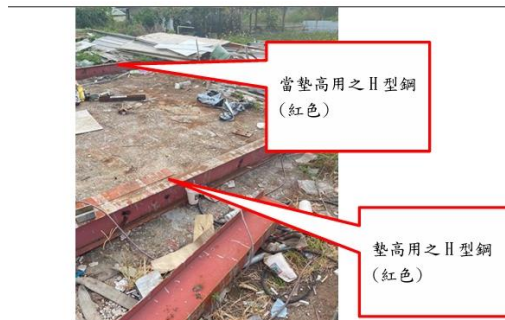
災害發生地點，肇災之H型鋼已搬離，只剩2個當墊高用之H型鋼(紅色)。
