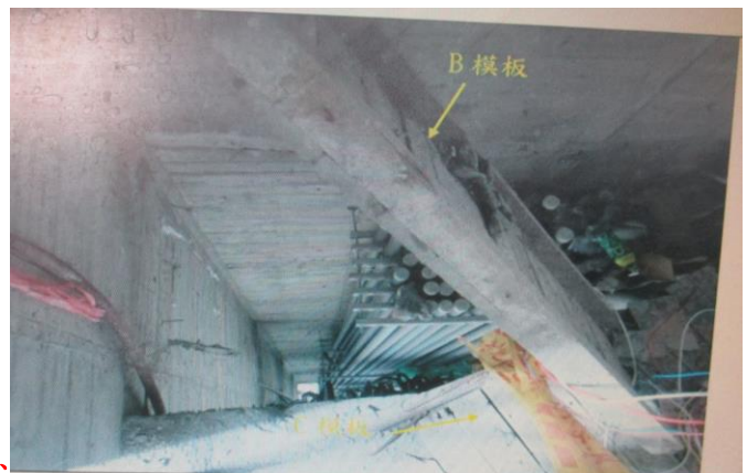
照片：罹災者廖○○從7樓管道間墜落至管道間正下方1樓地面
