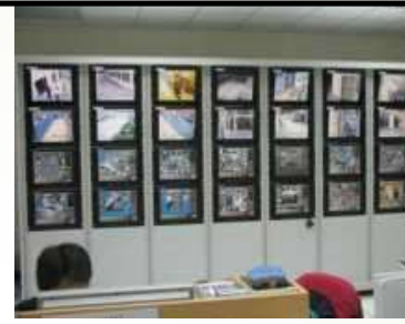
ITV system 監視系統
