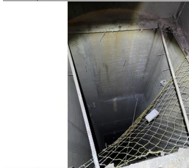
照片2 電梯井內剩2根支撐工作平台之鋼筋及殘留2邊之安全網，另有1根支撐鋼筋掉落並卡於14樓與15樓間。
