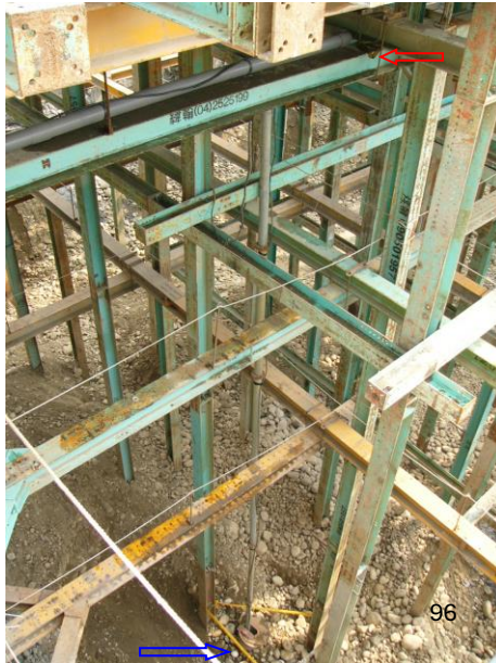
紅箭頭處為罹災勞工所遺留之安全帶，藍箭頭處為罹災勞工墜落後遺留現場之安全帽，墜落高度15.9公尺。
