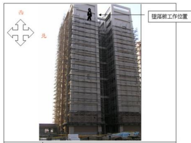
照片一 災害發生於○○○棟「○○○新建工程」之工地。
