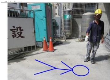
說明一 | 災害發生於本工程之1樓室外地面處。
