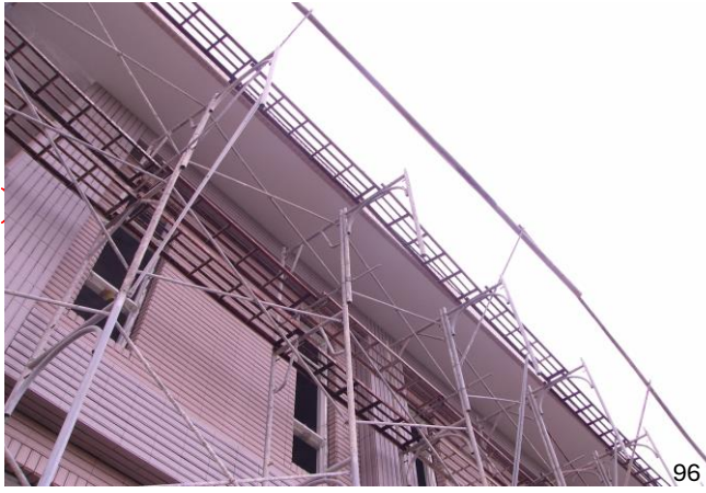
東側施工架未設置護欄、安全網或安全母索等防護設備，
