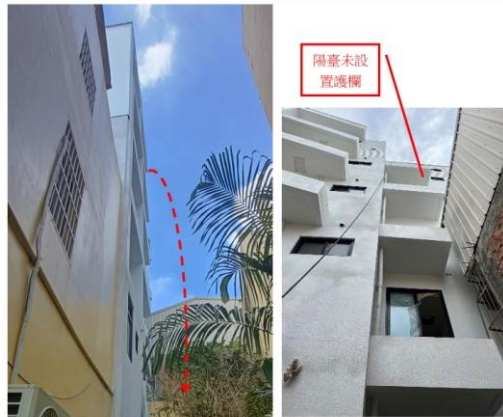
罹災者自6樓後陽臺墜落至高差約14.4公尺鄰房2樓陽臺。
