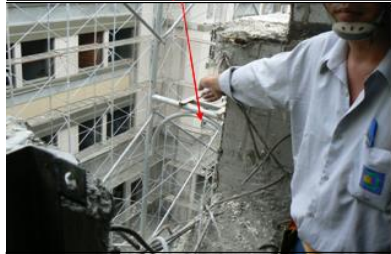
罹災者從所站××戶外牆施工架工作台第6層處往旁邊未鋪設施工架工作台之方向墜落，並墜落於距地高約9.9公尺之××戶地面上。
