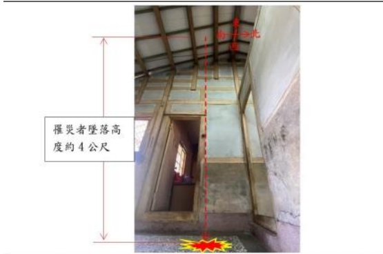
災害發生時，屋頂屋架下方未裝設堅固格柵或安全網等防墜設施，墜落高度約4公尺。
