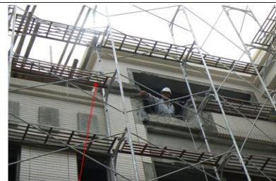
罹災者從所站××戶外牆施工架工作台第6層處往旁邊未鋪設施工架工作台之方向墜落，並墜落於距地高約9.9公尺之××戶地面上。
