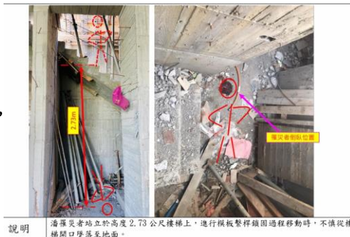
說明 潘罹災者站立於高度2.73公尺樓梯上，進行模板繫桿鎖固過程移動時，不慎從樓梯開口墜落至地面。
