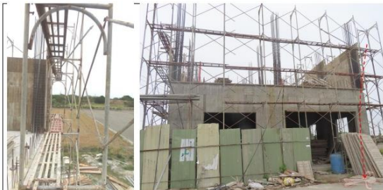
施工架工作臺寬度30公分及未設置護欄(未設內側交叉拉桿及雙側下拉桿); 罹災者自第4層施工架工作臺(高度6.8公尺)墜落至地面。
