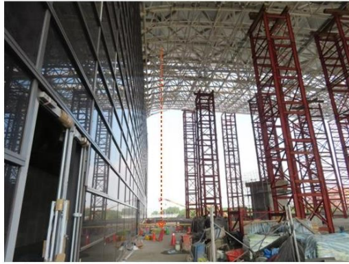
說明 魏 OO 罹災者由空間桁架上墜落至2樓樓板，墜落高度約18.7公尺。
