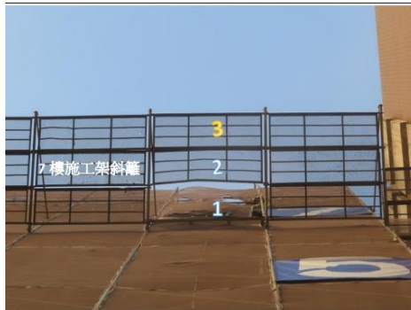
罹災者自高度28.8公尺之8樓外牆施工架外側開口墜落後，經撞擊7樓處施工架編號2斜籬再由編號1斜籬開口墜落至地面致死
