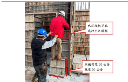
災害發生時，罹災者於地面上放置一塊模板斜靠在已組好之電梯牆模板上，站上該斜靠之模板上緣，並將右手伸進已組立好三塊電梯牆模板內，將設置於已綁緊好電梯牆鋼筋上之螺桿由第三塊模板穿孔處拉出。
