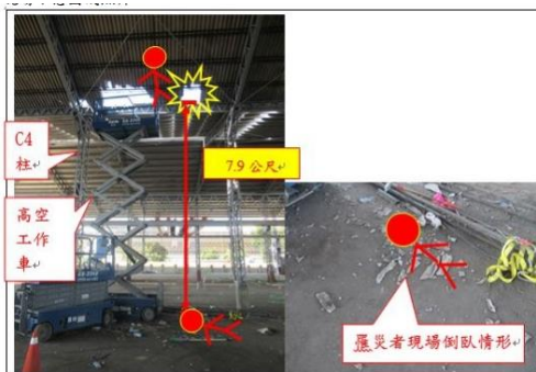
說明：照片：罹災者踏穿石綿瓦屋頂墜落至地面，墜落高度為7.9公尺。
