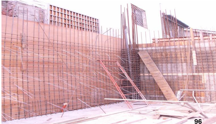
罹災者自3.6公尺高之牆壁模板上墜落時臉頰被鋼筋插入受傷。
