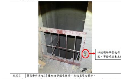
照片1 罹災者作業之15樓垃圾管道電梯井，未設置警告標示。
