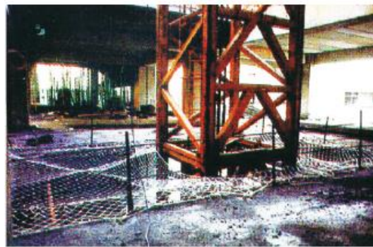
塔吊缺口安全網
