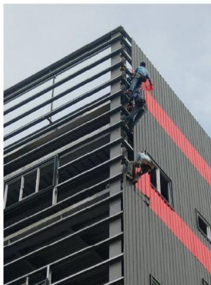
作業人員採用不適當作業方式
