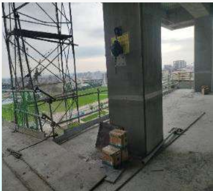
捲揚防墜器安裝位置及高度不當
