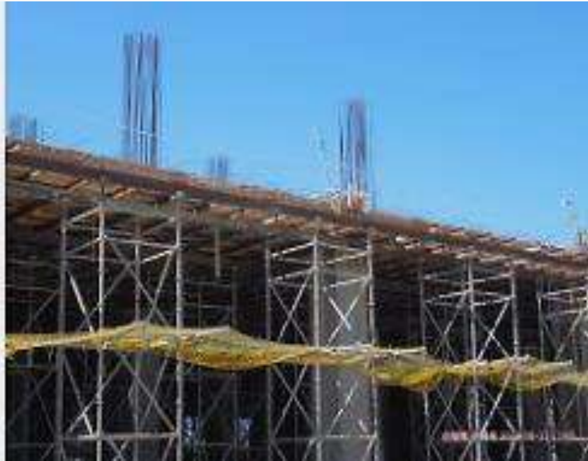
安全母索非護欄，仍應設置適當護欄
