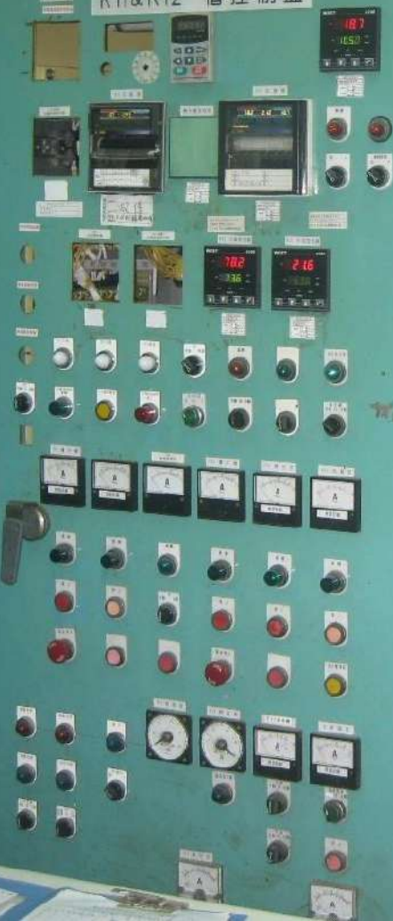
R11&R12 槽控制盤
