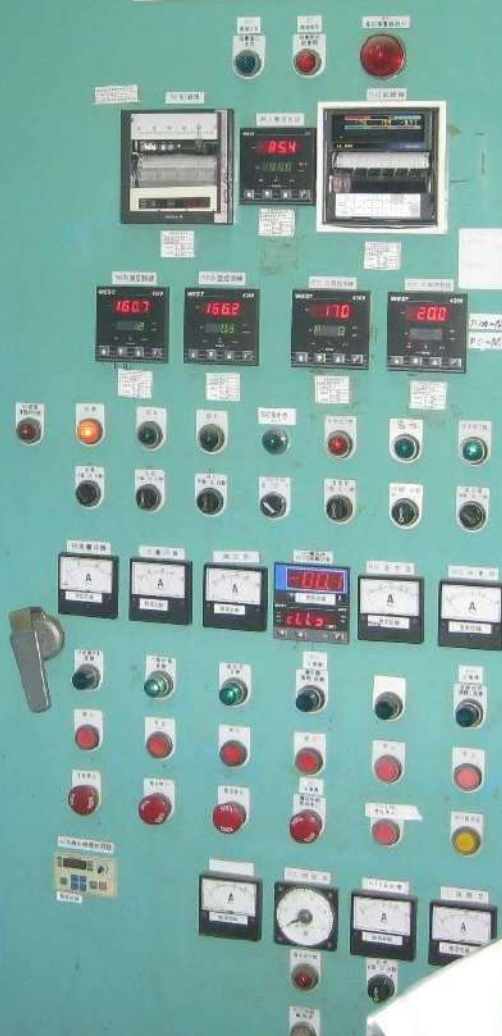
R6&R13 槽控制盤
