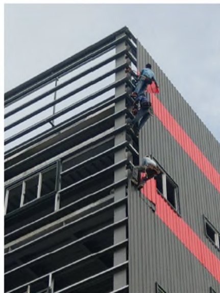
作業人員採用不適當作業方式
