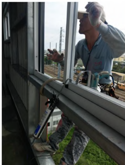
作業人員使用不正確之安全帶進行作業
