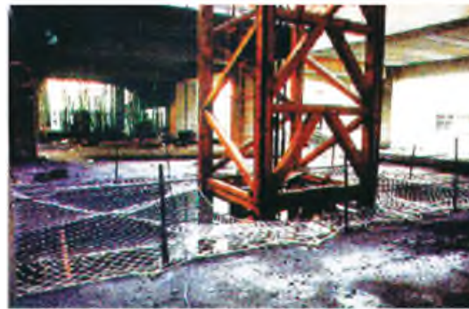
塔吊缺口安全網
