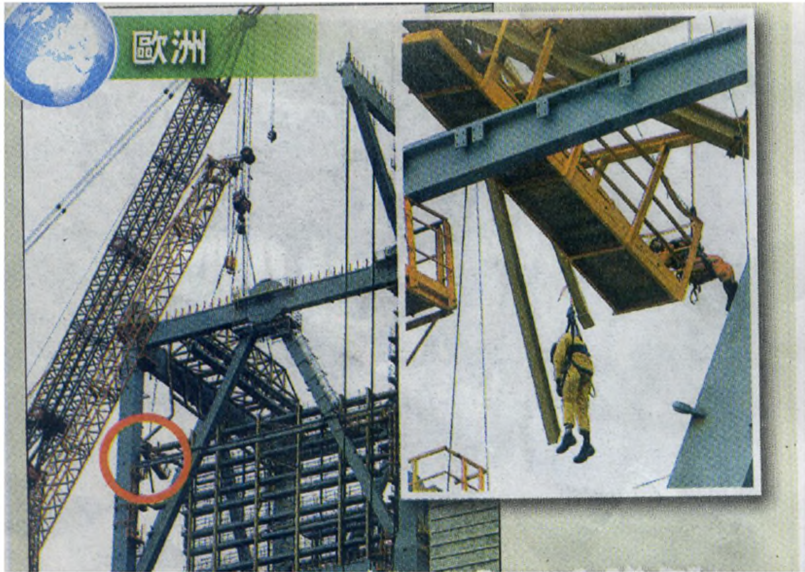
德國，鋼樑坍塌掉落百公尺，其中一人雖有安全帶但懸吊過久導致死亡
