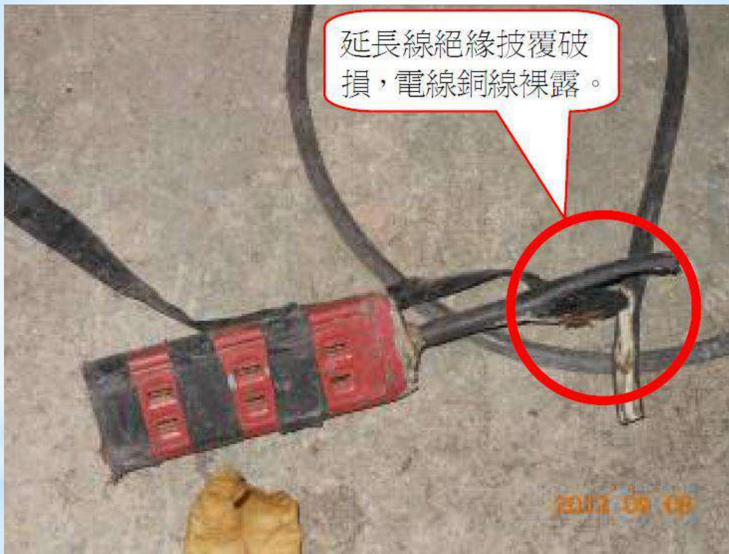
延長線表皮破損電線銅線裸露位置
