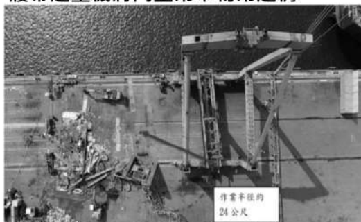
履帶起重機翻倒情形
