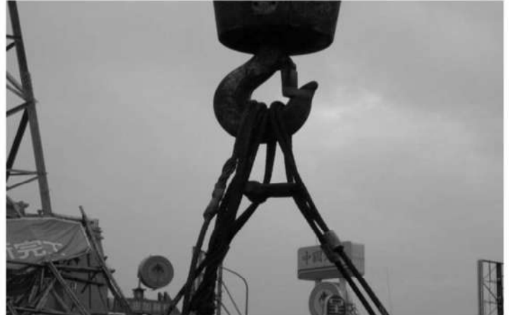
懸吊吊籃(搭乘設備)之鋼索必須裝入起重機吊鉤內，且吊鉤應有防滑舌片
