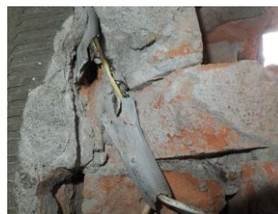
破碎機鑽頭打到壁面電壓110伏特之電源線。
