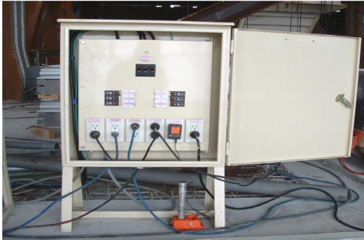
臨時用電所使用之配（分）電箱設置箱、蓋、中隔板等防止人員誤觸帶電部分。
