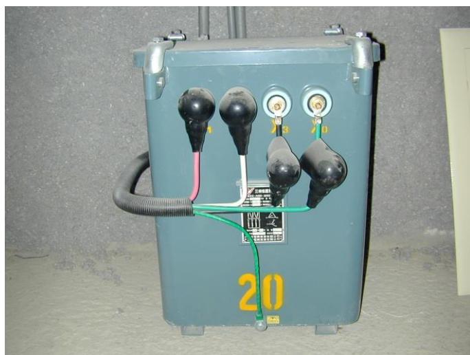
變壓器帶電部份隔離保護
