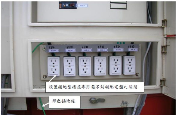
配（分）電盤、箱設置插座專用箱、標示使用電壓、使用接地型插座，且不妨礙箱門之關閉。
