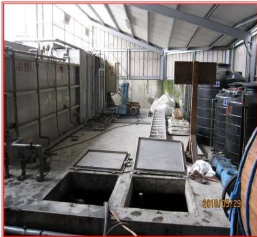
災害發生處所概況
