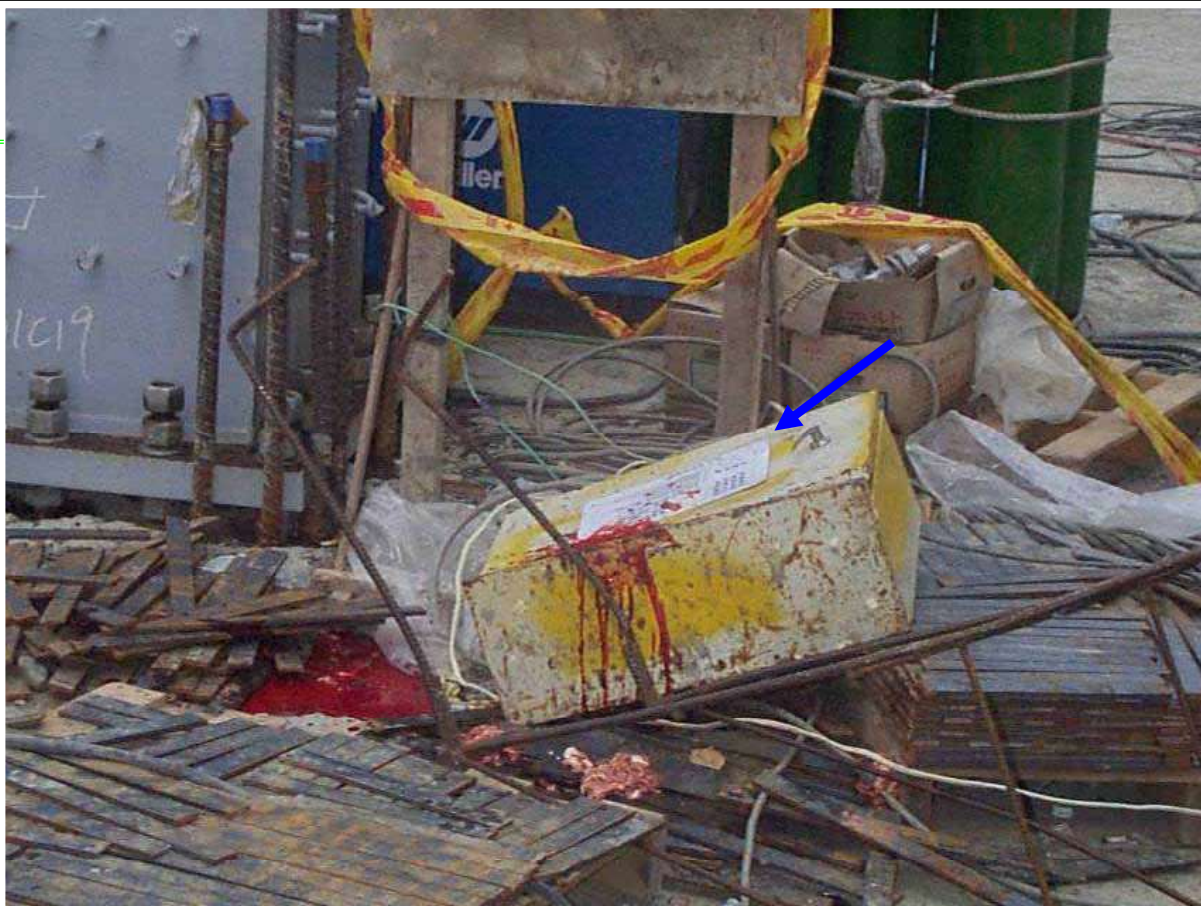
罹災者墜落頭部撞擊配電箱
