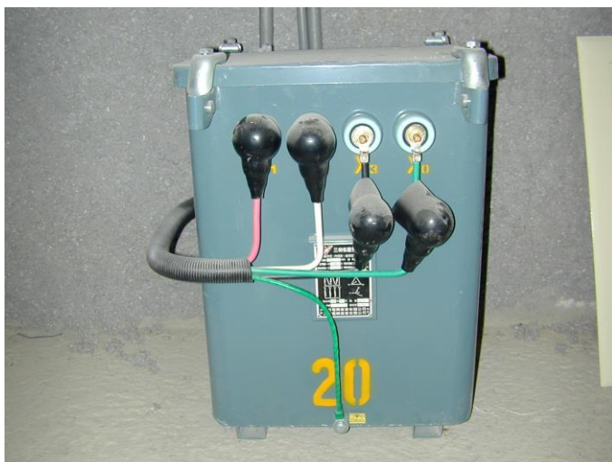
變壓器帶電部份隔離保護
