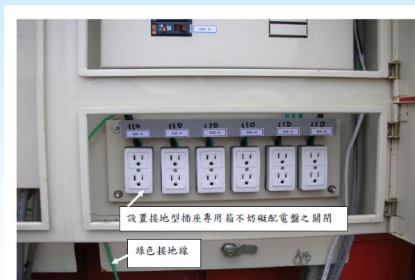
配（分）電盤、箱設置插座專用箱、標示使用電壓、使用接地型插座，且不妨礙箱門之開閉。
