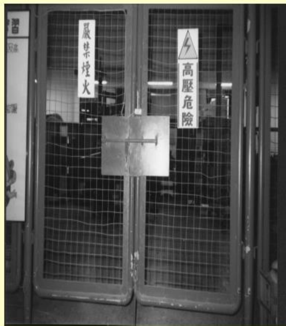
高壓試驗場以鐵網圍住並標示警告
