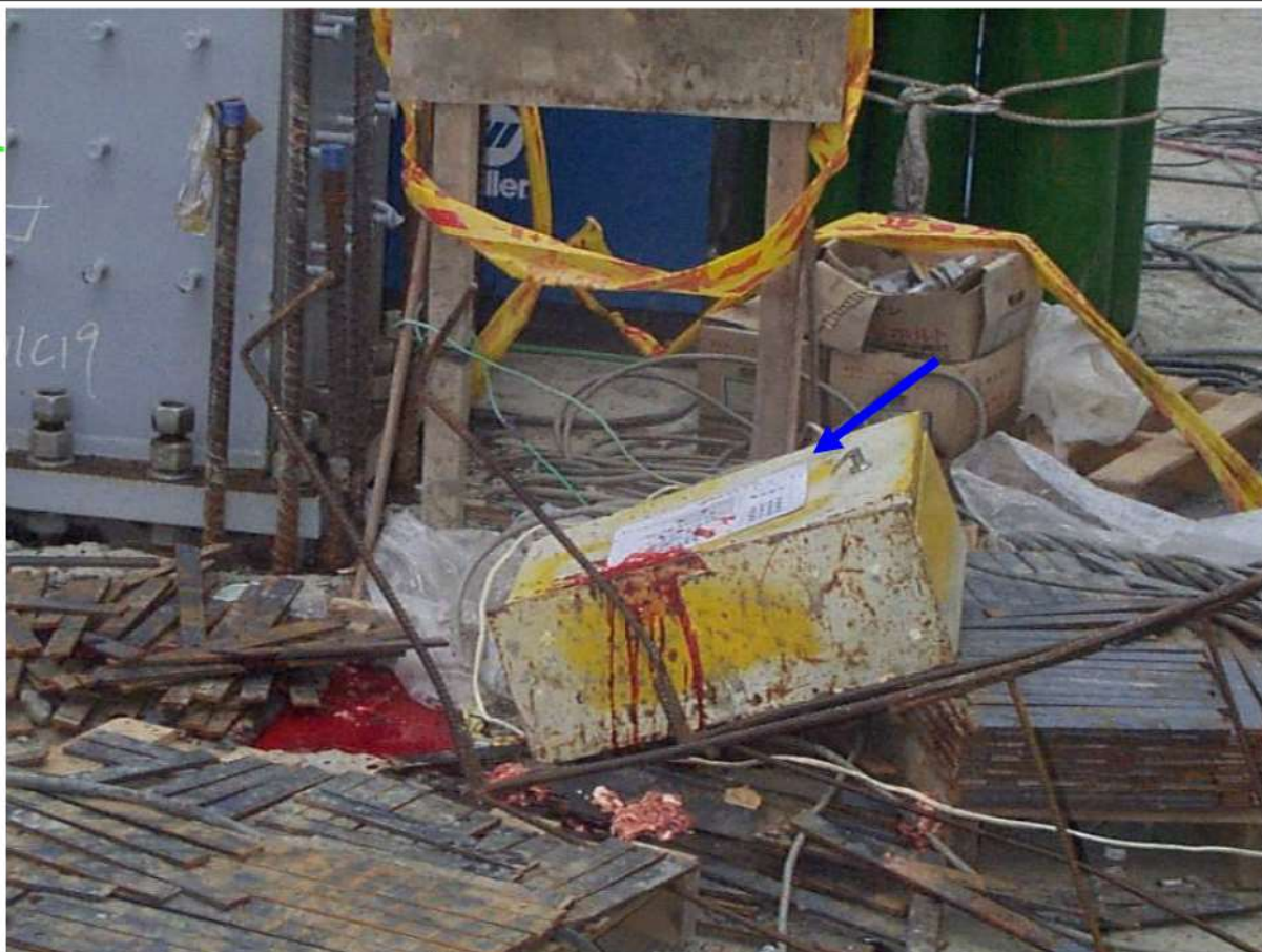
罹災者墜落頭部撞擊配電箱
