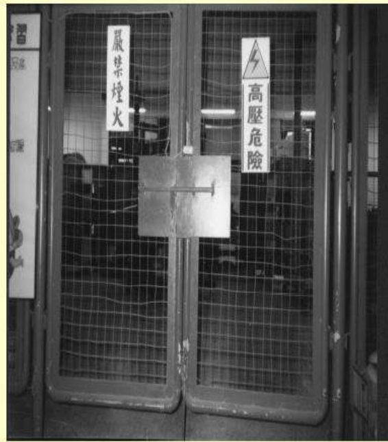
高壓試驗場以鐵網圍住並標示警告
