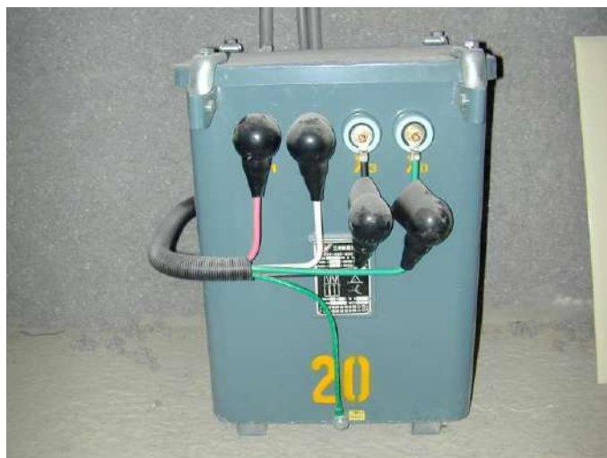
變壓器帶電部份隔離保護
