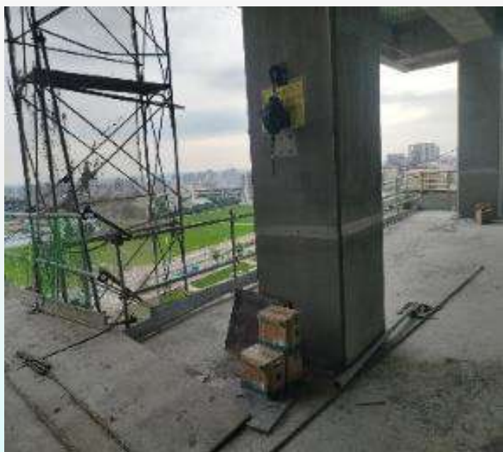
捲揚防墜器安裝位置及高度不當
