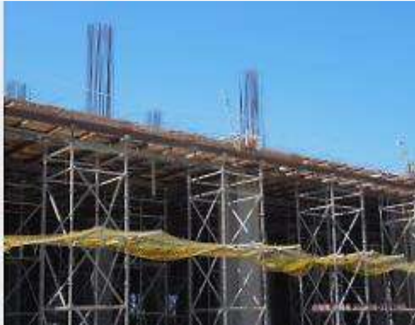
安全母索非護欄，仍應設置適當護欄
