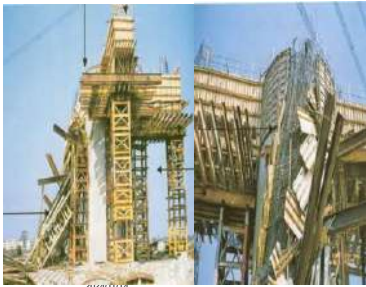
模板受上浮風力吹襲鬆動於灌漿作業時造成造成模板倒塌
