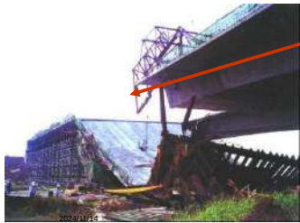
中二高竹南交流道崩塌1死2傷
