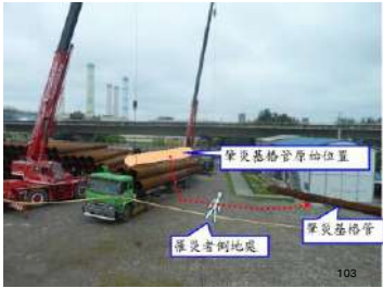
災害現場照片（虛線為基樁管飛落之路徑）
