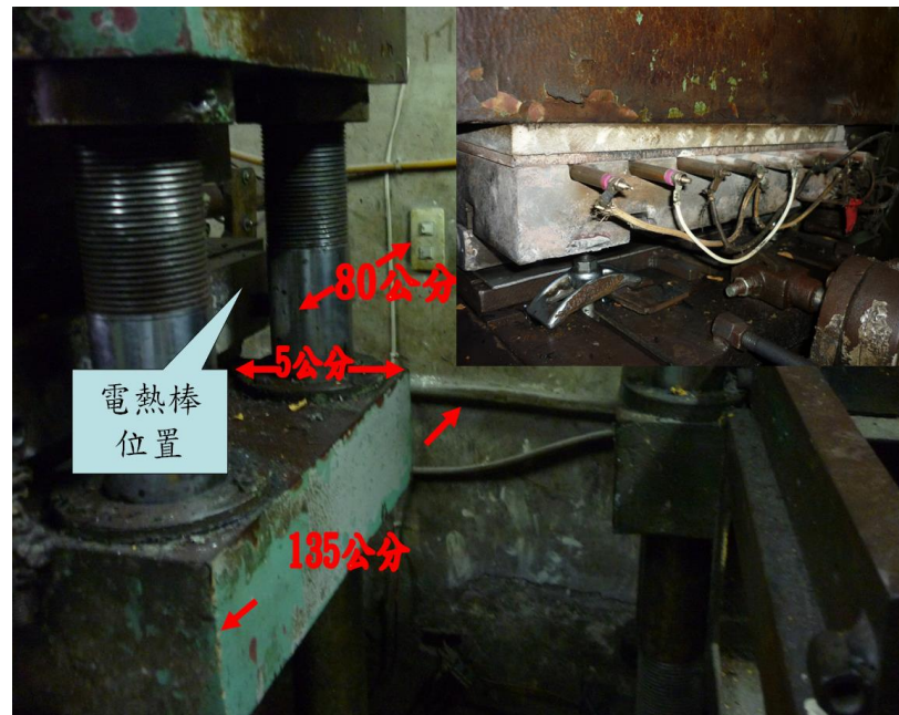
2號橡膠油壓機電熱棒位置(電燈電源開關處距2號機電熱棒位置約：80公分；距2號機前方約135公分；電熱棒距2號機右側約5公分)
