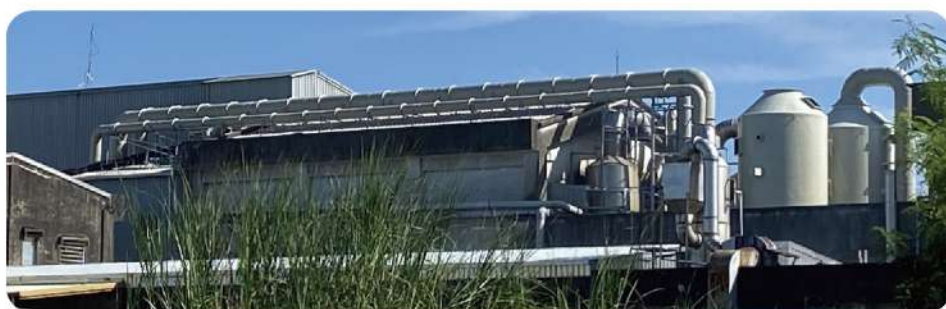
圖7、屋頂上風管及除臭洗滌塔遠視照
