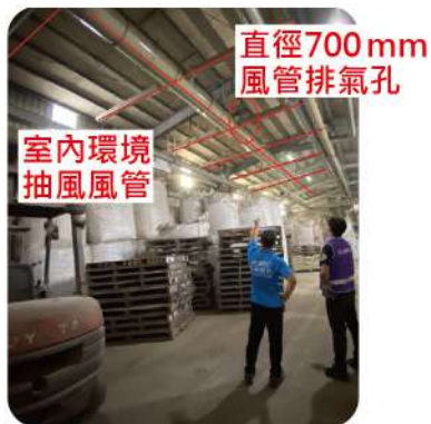
圖1、雞糞原料堆置區改善後管線
