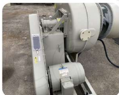
圖5、15 HP風機，屋外型，材質FRP
