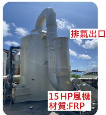
圖2、空氣清淨除臭洗滌塔
