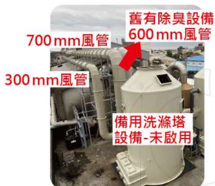
圖3、屋頂風管照、空氣清淨除臭洗滌塔(圖中右塔，為此次改善項目)
