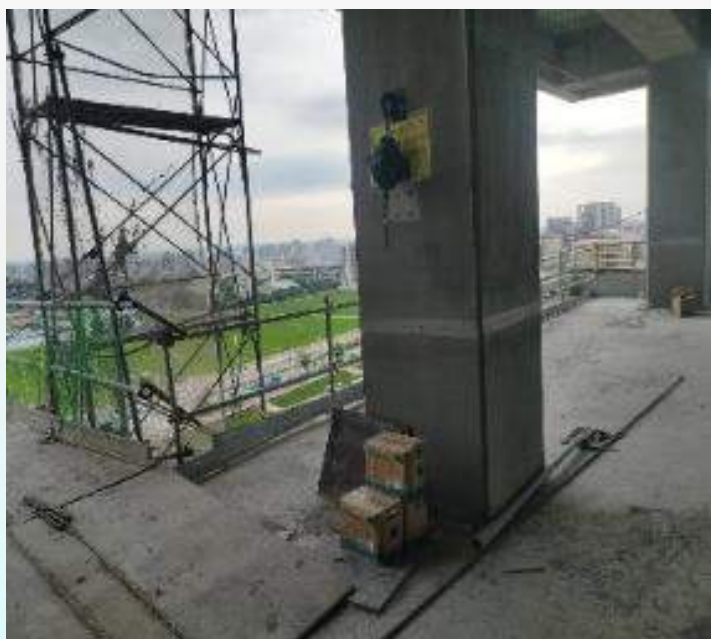
捲揚防墜器安裝位置及高度不當
