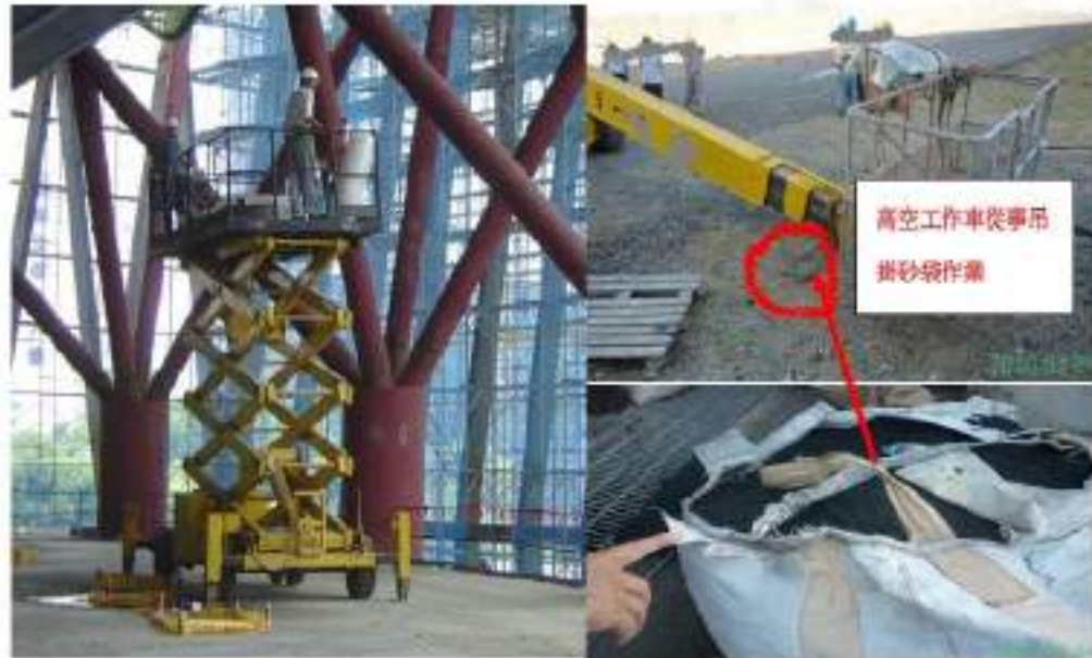
圖 2-8 高空工作車作業勞工未佩戴安全帶並從事供為主要用途以外之作業
