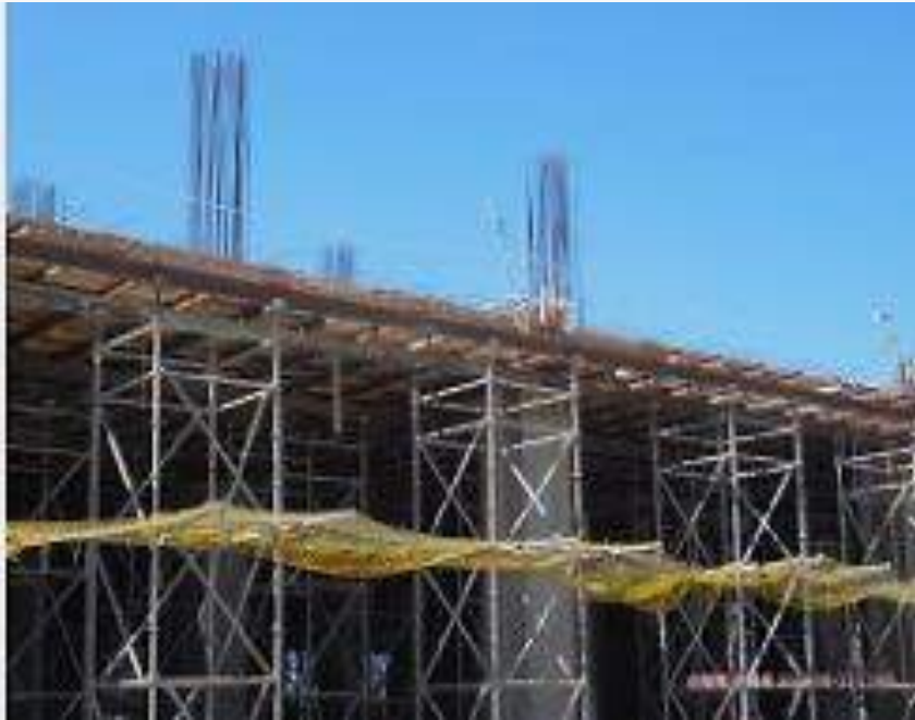
安全母索非護欄，仍應設置適當護欄
