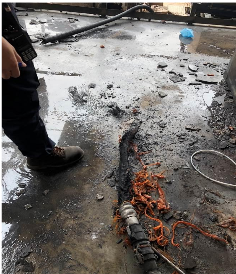
軟管破裂造成丁酮洩漏
