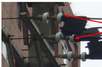
11 仟伏 (11kV) 礙子數量：約 1~2 只
