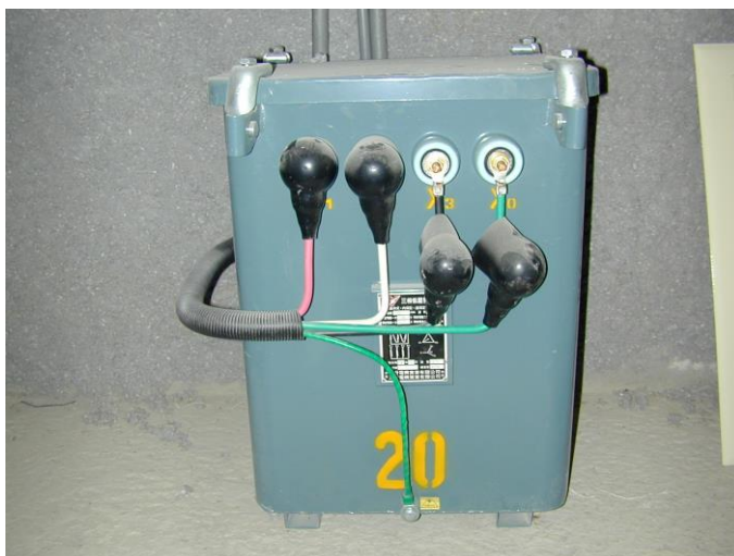
變壓器帶電部份隔離保護
