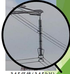
345 仟伏 (345kV) 礙子數量：約 19 只以上 線間間距：約 7.8 公尺以上
