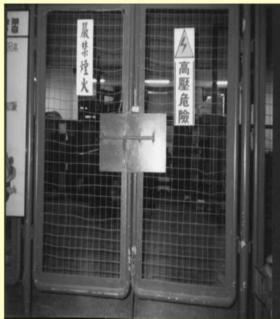
高壓試驗場以鐵網圍住並標示警告
