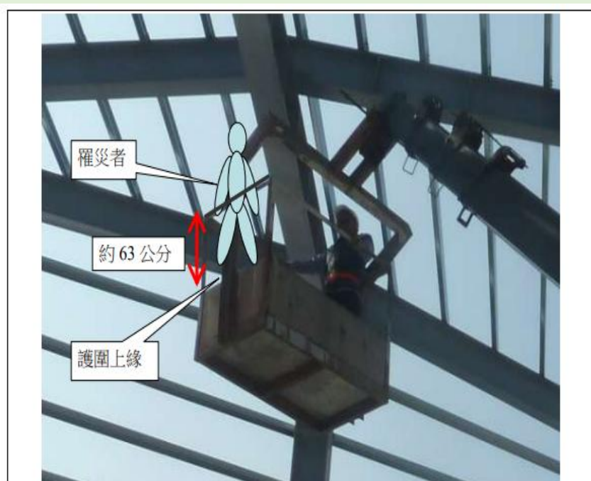
說明一 罹災者踩在工作台護圍上緣作業
