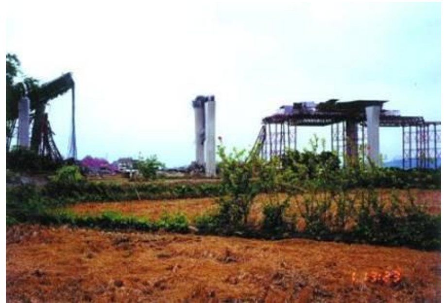
C306標高架橋混凝土施工支撐倒塌位置
