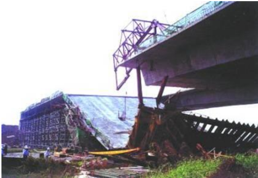
C 3 0 4 B 標 橋 面 版 倒 塌
