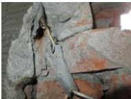
破碎機鑽頭打到壁面電壓110伏特之電源線。
