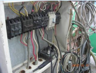
臨時分電盤未設漏電斷路器
