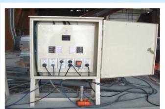
臨時用電所使用之配（分）電箱設置箱、蓋、中隔板等防止人員接觸帶電部分。
