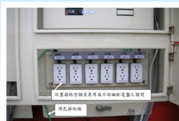
配（分）電箱、箱設置插座專用箱、標示使用電壓、使用接地型插座，並不妨礙箱門之關閉。
