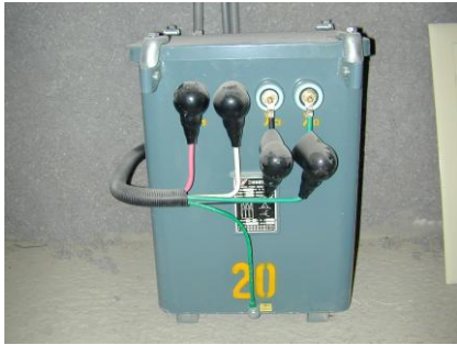
變壓器帶電部份隔離保護
