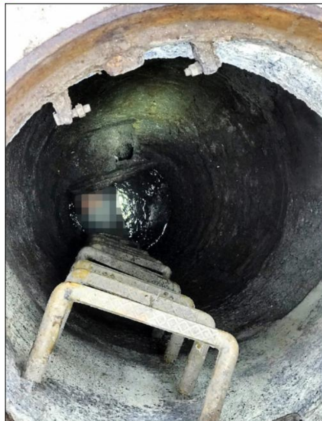
下水道工人疑似吸入過多硫化氫，失去意識漂浮在污水上。（記者王裡翻攝）
