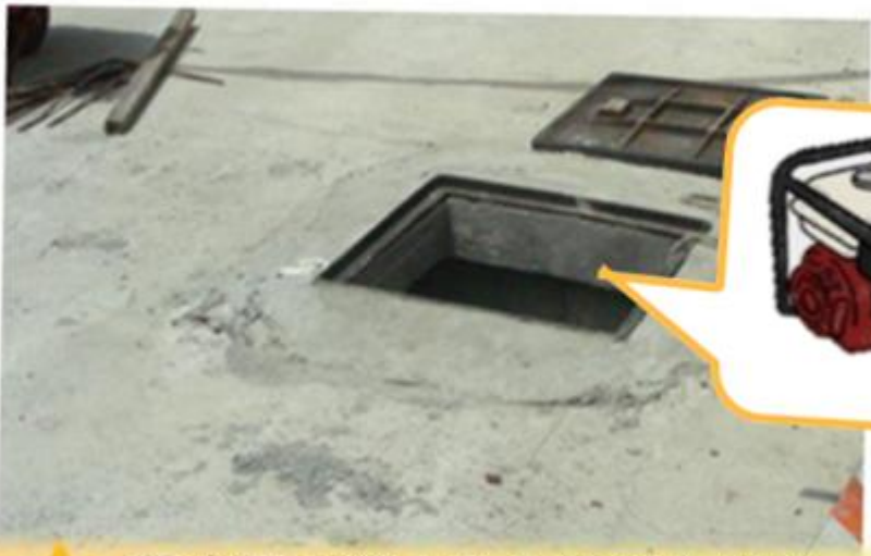
★ 污水下水道人孔內使用內燃機
