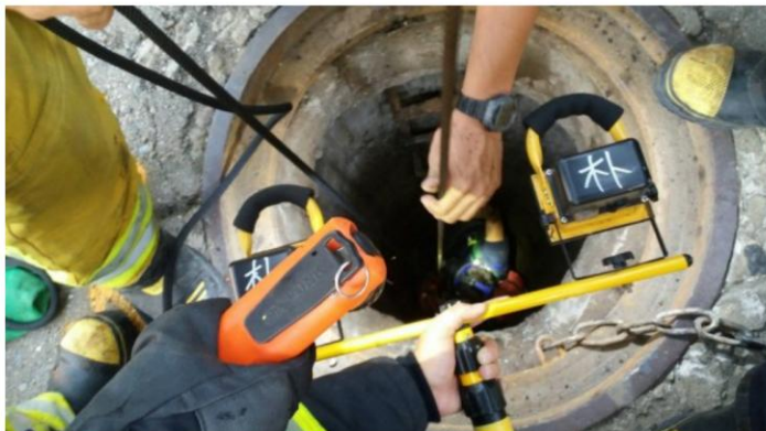
嘉義區監理所前污水下水道發生工人昏迷意外，救援人員搶救。（記者林宜樟翻攝）
