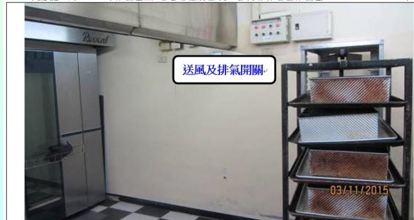
說明 照片1 改善前, 未設置一氧化碳監控及警示設施。
