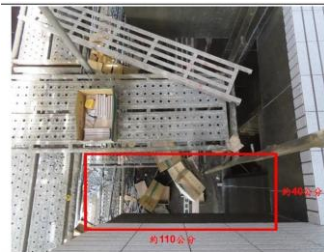
說明 墜落開口
