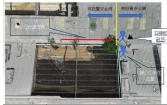
照片一 據目擊者謝○○所述，罹災者拆除石綿板後，將石綿板搬運至交由其收存，罹災者正在搬運石綿板，不知為何突然往底下沒有石綿板地方跑去，造成踏破石綿板墜落致死。
