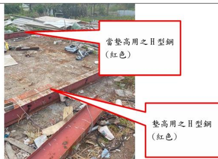
災害發生地點，肇災之H型鋼已搬離，只剩2側當墊高用之H型鋼(紅色)。
