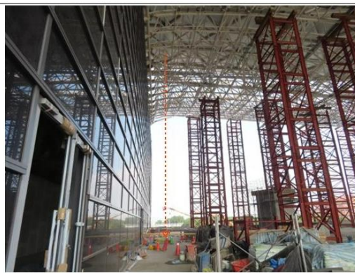
說明：魏○○罹災者由空間桁架上墜落至2樓樓板，墜落高度約18.7公尺。
