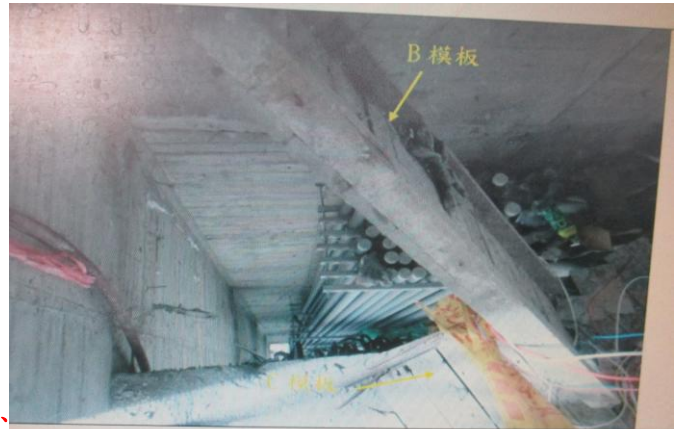
照片：罹災者廖○○從7樓管道間墜落至管道間正下方1樓地面 高度約為19.5公尺。(本照片由6樓管道間往下拍)
