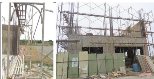
施工架工作臺(高度6.8公尺)墜落至地面。
