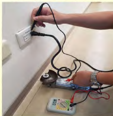
開關在火線,感應電壓消失約0伏特
