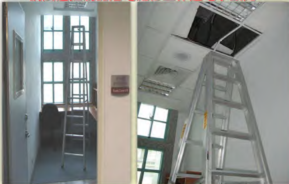
勞工站於鋁製合梯上從事天花板上220V空調風速控制器活電維修工作遭電擊致死
